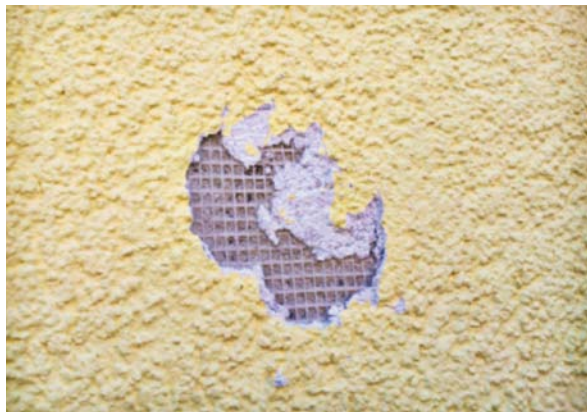
Gerade neuere, gut isolierte Fassaden mit dünnem Oberputz erwiesen sich anfällig für Hagelschäden.
