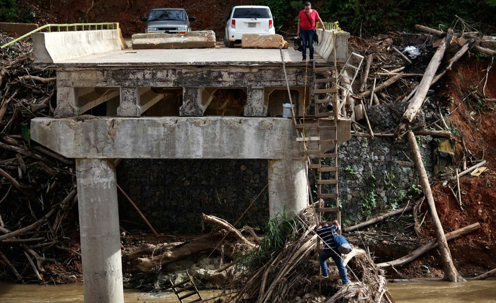
Zerstörte Brücke in Puerto Rico im September 2017
