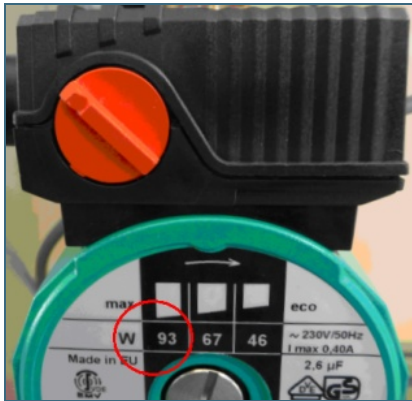
Abb. 1: An der abgebildeten Heizungsumwälzpumpe können drei Leistungsstufen eingestellt werden (roter Schalter). Eingestellt ist die Stufe 3, bei der die Leistungsaufnahme laut Typenschild 93 Watt (W) beträgt.
